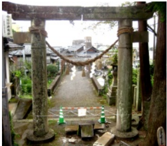
温泉神社の石鳥居が一部崩壊しました。この鳥居は152年前の江戸時代、嘉永6年(1853)に再建されたものでした。隣接の社務所は無事でした。他にも、塩南町・浜町の旧堤防の桜並木や大明神境内、県道多良線の樹木など、局地的な倒木の被害が発生しました。
