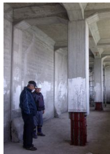
鉄筋がむき出しになった樋門の内部
